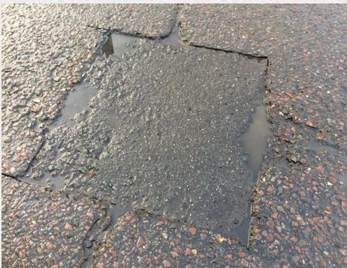
Характерное разрушение ремонтной карты
