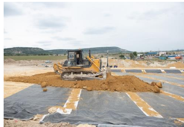
Устройство пригрузочного слоя методом сдвига при укладке бентонитового мата при строительстве трассы «Таврида»
