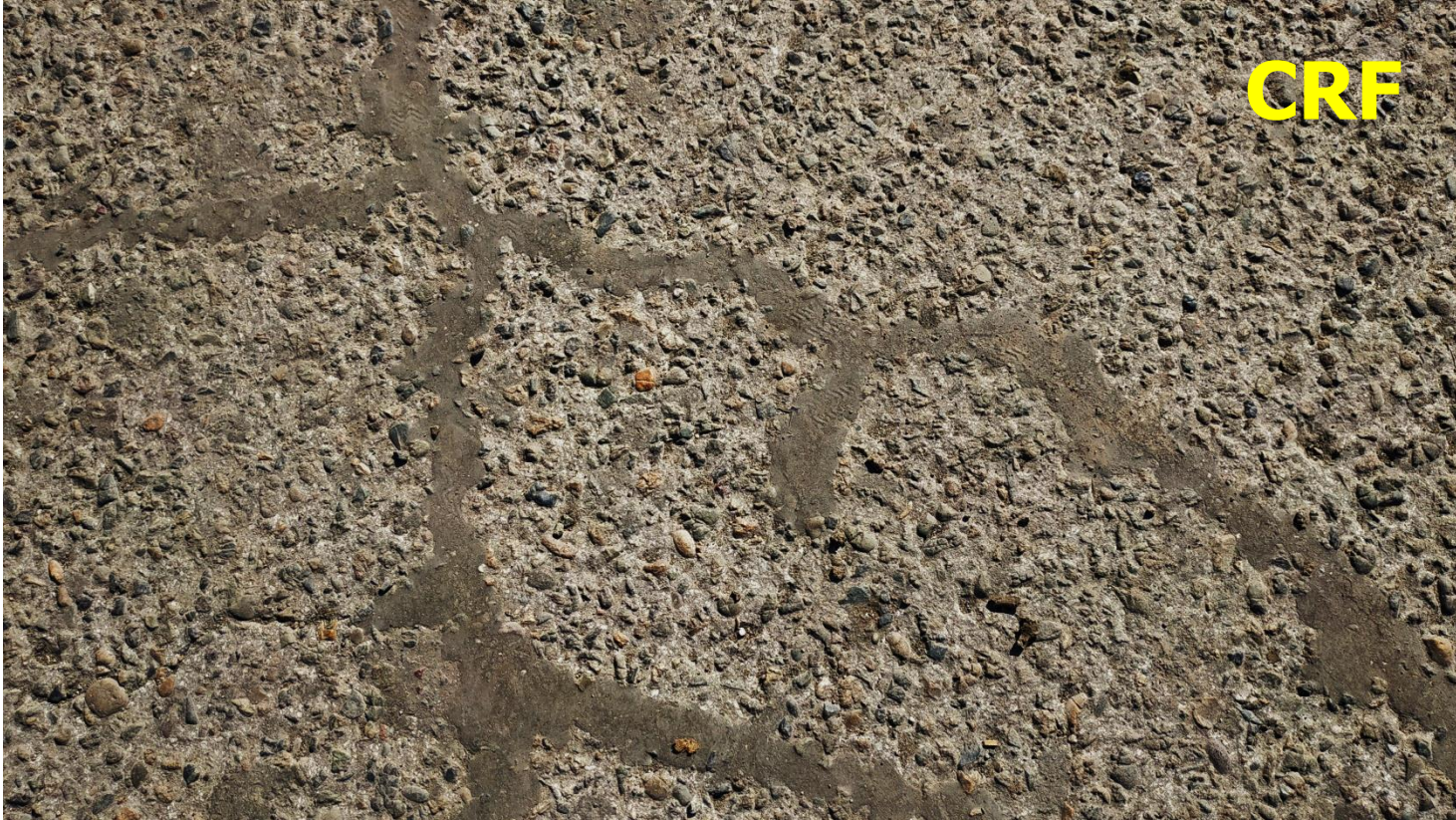
Барнаул, 2019. Подъезд к АБЗ. Возраст санации – 1 год
