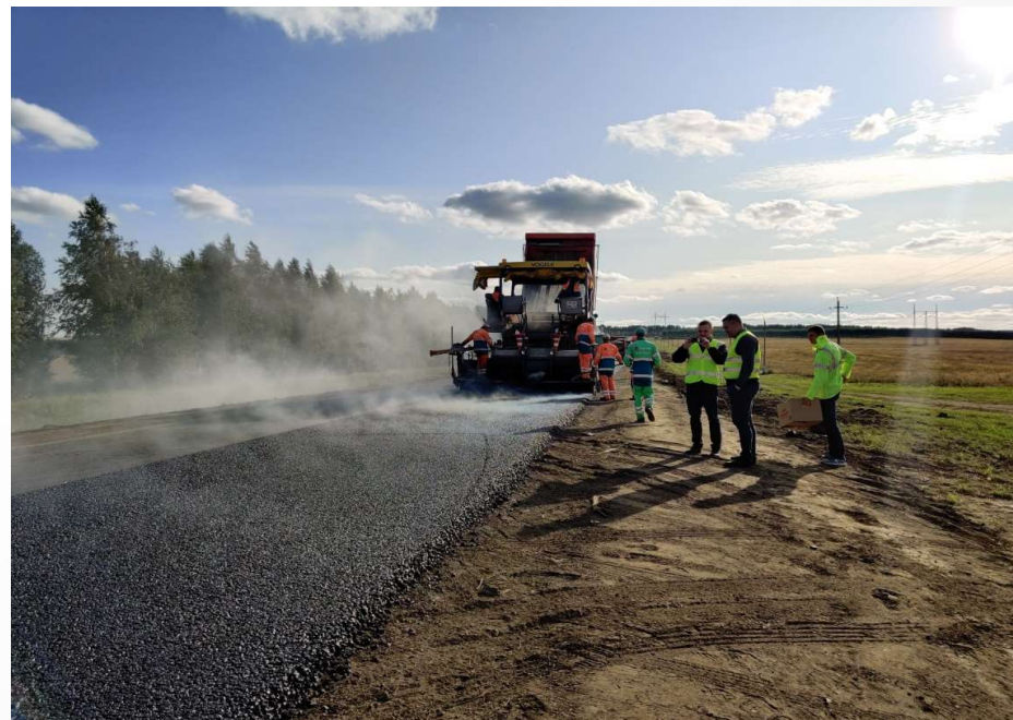
участки автомобильной дороги «Казань-Оренбург-Бута-Аппаково» Альметьевского района РТ с применением добавок VIATOR PLUS FER, VIATOR PLUS СТ 40
