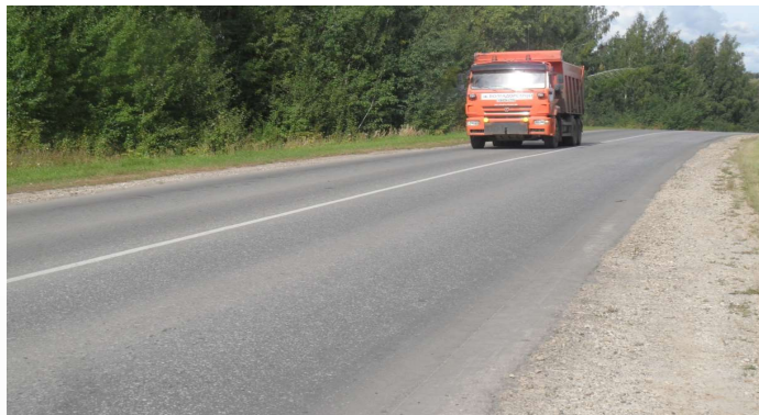
Состояние дорожного покрытия после 2 лет эксплуатации
