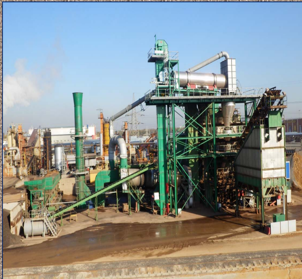
Установка с дополнительным барабаном на АБЗ «Капотня»
