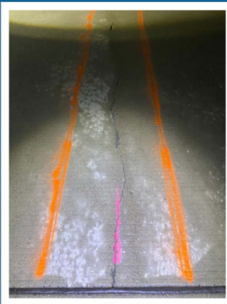
Трещина со сколом
